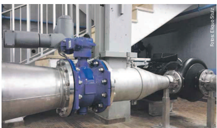
Zulauf zur Pumpenturbine mit Flanschklappe und 24 VDC Schwenk-Antrieb.
